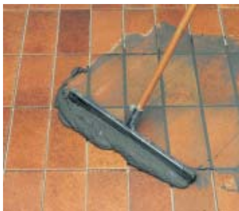
Stendere PCI-Fugenbreit nelle fughe per tutta la loro profondità. Asportare l'eccesso del sigillante ...
